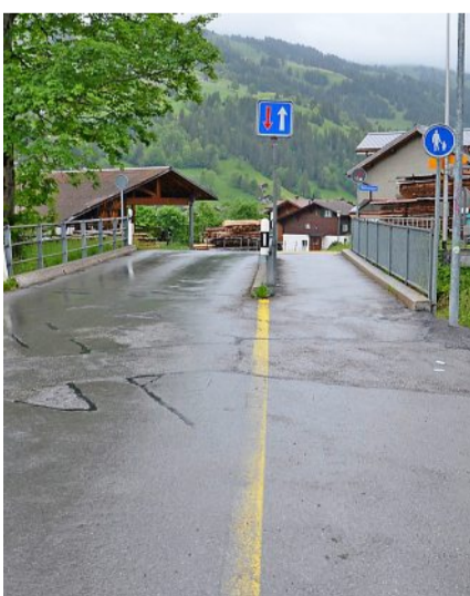
Auf der Aegertenstrasse sind die Schäden deutlich. Enge Stellen wie bei der Wallbachbrücke werden leicht aufgeweitet. Foto: Fritz Leuzinger
